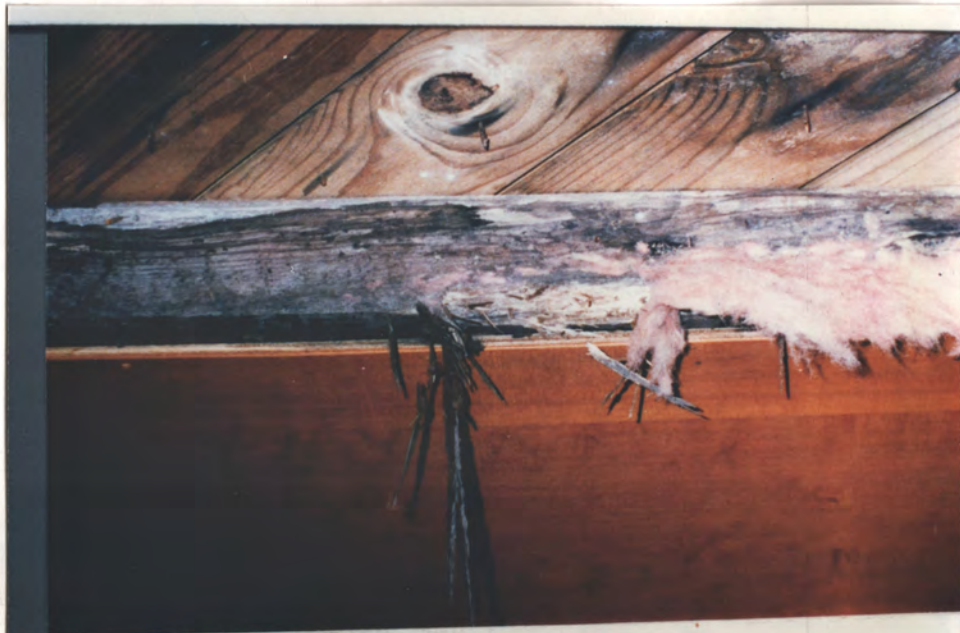
N. BR roof rot
